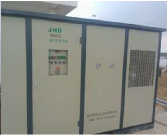
备用油气回收装置
